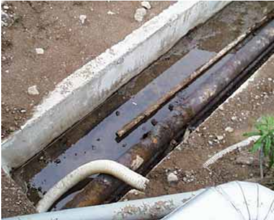
Kuva 25. Betonikanaali, jossa putkistot olivat kosteassa tilassa.
