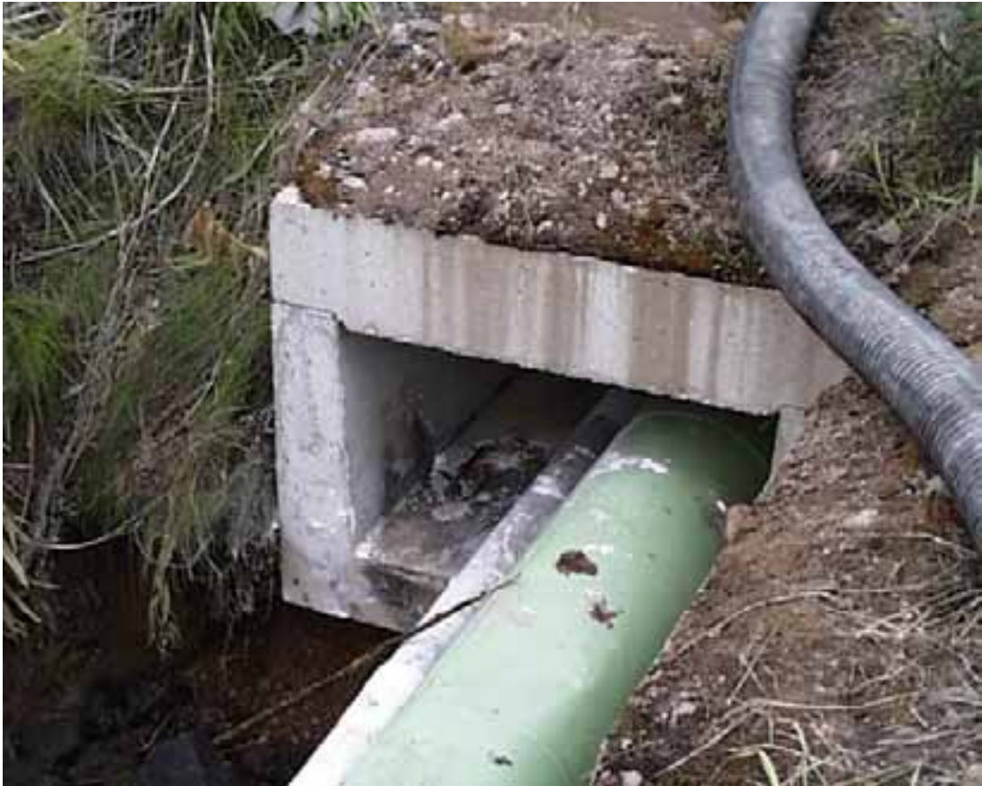
Kuva 22. Laiturille menevän tien alitus. Pahin vuotokohta. Tunnelin vasemmassa alakulmassa kiteytynyttä fenolia.
