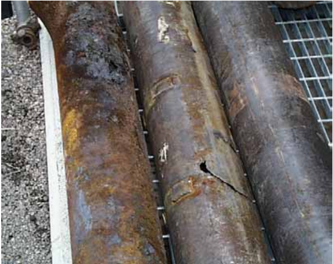
Kuva 29. Keskimmäisen putken paha syöpymä.
