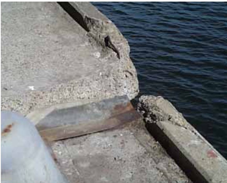
Kuva 21. Laituri 1, rikkoutunut betonireunus keräilyalueella.
