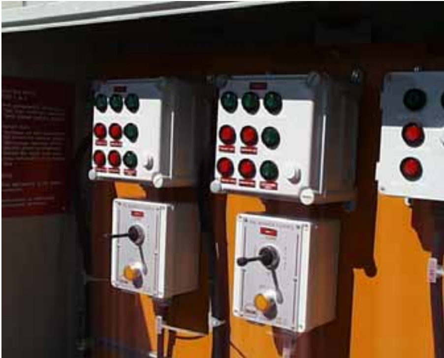
Kuva 16. Palotykkiä ohjaus pumppuaseman seinämällä
