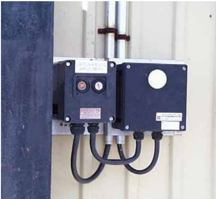
Kuva 19. Laiturikaivon tyhjennuspumpun ohjauskeskus laiturivalvomon seinässä.
